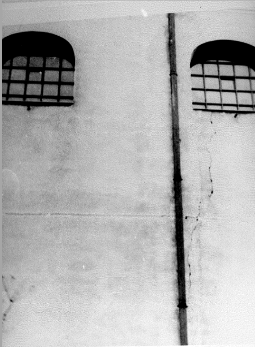
Trhlina v severní obvodové zdi kostela.
